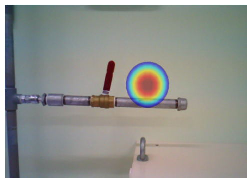
図2 エア漏れ検出画像
