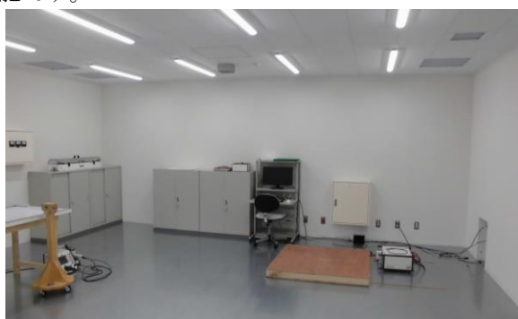
図1 シールドルーム内部
